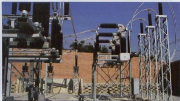
Fig. 9a: MTS incomer bay using a COMPASS unit.
