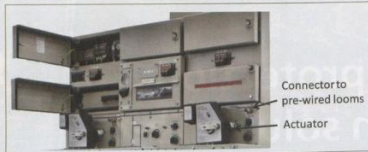
Fig. 3: Retrofit actuator on SF6 RMU (Lucy Switchgear).
